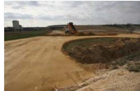
Imagen de las obras de la autovía de Romica. / JOSÉ MIGUEL ESPARCIA
